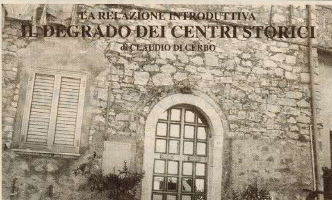
Esempio (comunissimo anche in altri centri) di una "summa" di interventi che deturpano un fabbricato del centro storico di Castropignano. Si nota: l'impiego di alluminio anodizzato (addirittura con vetro specchiato) per gli infissi; l'intonaco di cemento che ricopre malamente la pietra; fili per rete elettrica e telefonica; tubi di gas; etc.
